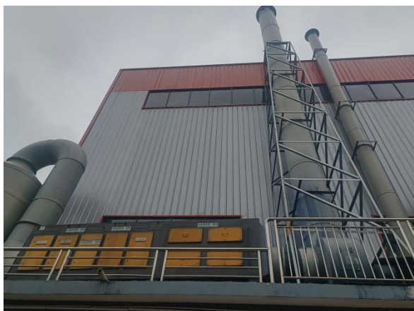
废气处理设施
