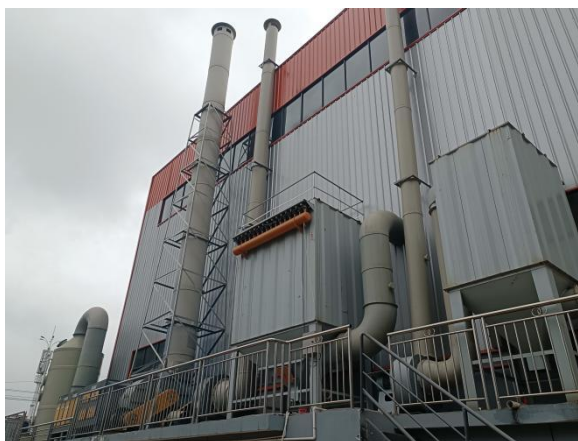
废气处理设施
