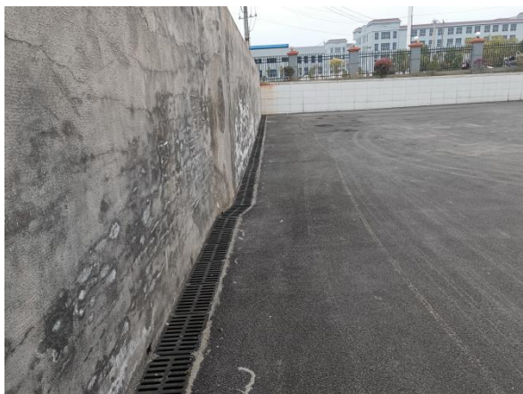
雨水收集管网
