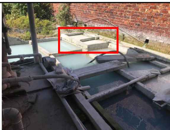
制釉废水沉淀池
