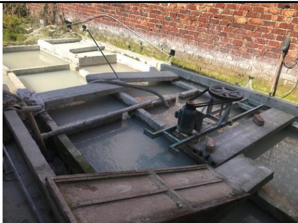
多级絮凝沉淀池
